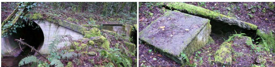
Caja de captación
